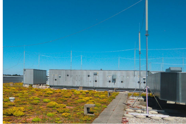
Bild 1: Getrennter Blitzschutz für gebäudetechnische Anlage (Quelle: Reinhard Schüngel)
