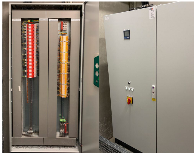
Bild 6: Anlagenschutz durch Überspannungsschutzgeräte (links Überspannungsschutz, rechts MSR-Anlage) (Quelle: Dehn SE + Co KG)
