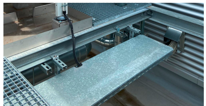
Bild 10: Anlagenschutz durch metallenen Kabelkanal (Quelle: Dehn SE + Co KG)
