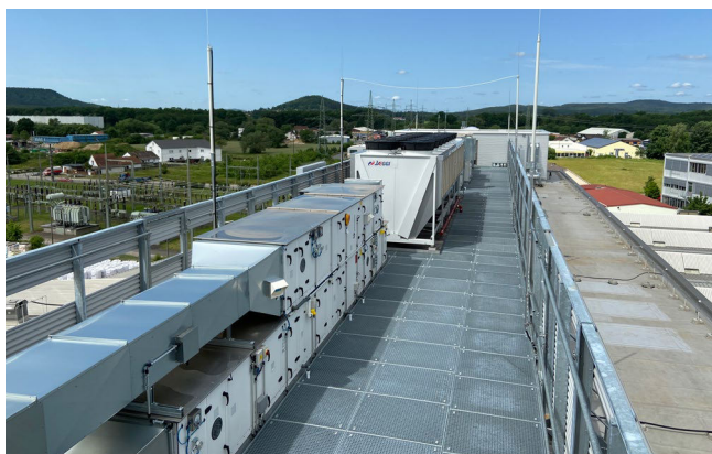
Bild 3: Getrennte Installation des Blitzschutzes mit isolierten Ableitungen (Quelle: Dehn SE + Co KG)
