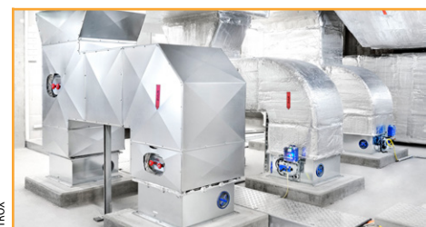
Brandschutzklappen in Lüftungsanlagen müssen regelmäßig geprüft und gewartet werden.
