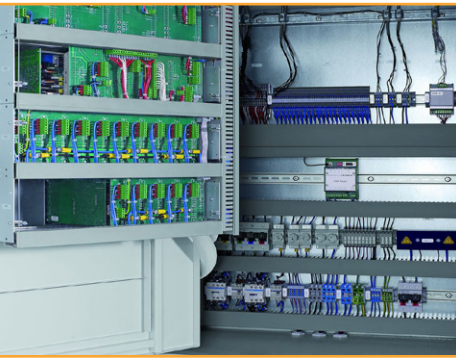
DIN EN 50171 beschreibt Anforderungen an zentrale Stromversorgungssysteme.
