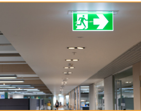
Sicherheitsbeleuchtungen sind zentraler Bestandteil von Brandschutzkonzepten.
