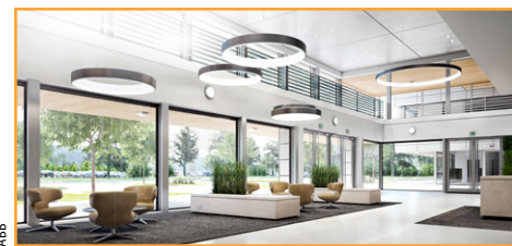
Überwachung mit DALI von Einzelbatterieleuchten bei der Sicherheitsbeleuchtung.
