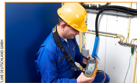
Einheitliche Prüfschritte für wiederkehrende Prüfungen elektrischer Anlagen.
