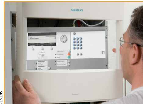
Änderungen für Brandmeldeanlagen durch die neue DIN VDE 0833-2.
