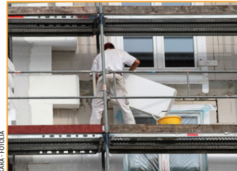
Styropordämmplatten mit HBCD gelten seit 30. September 2016 als gefährlicher Abfall.
