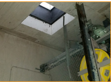
Energie entweicht durch eine unverschlossene Luke im Aufzugsschacht.
