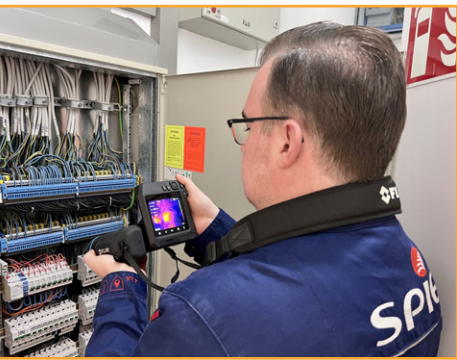
Mittels Wärmebildkamera können elektrotechnische Gefahrenquellen aufgedeckt werden.
