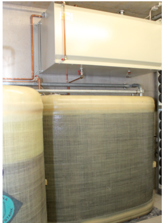
Haupt- und Tagestank einer Netzersatzanlage Quelle: BBK
