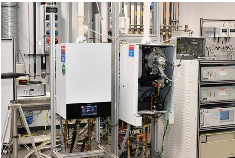
Bild 3: Prüfstand mit zwei Brennwert-Wandgeräten für den Betrieb mit 100 Prozent Wasserstoff.
